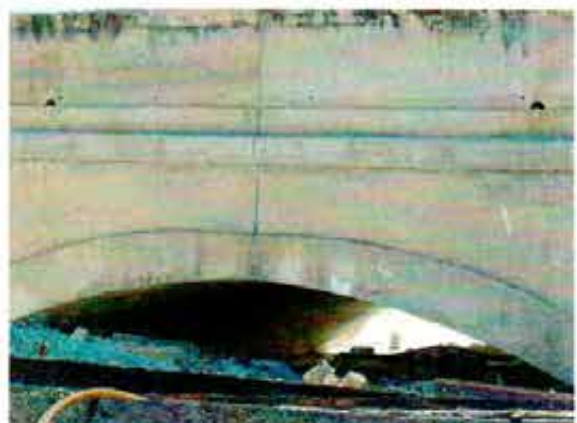
Manchas sobre los paramentos de los arcos
