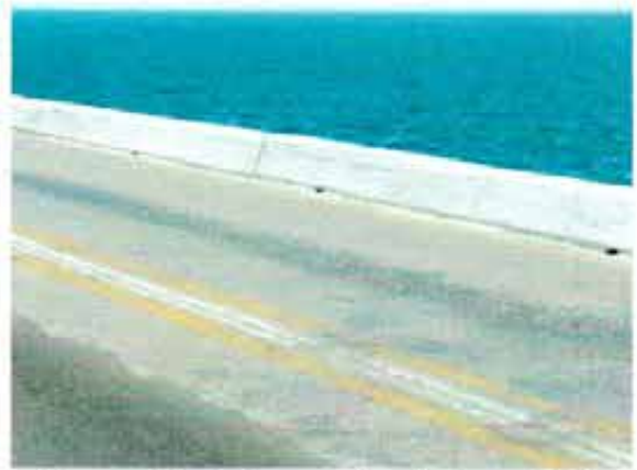
Ligero agrietamiento en pavimento. Parapeto bajo
