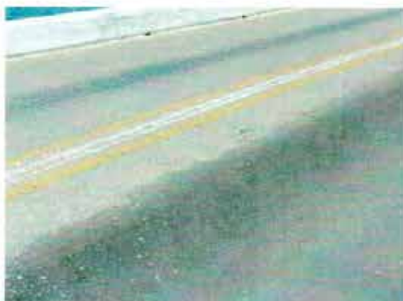
Junta central en pavimento asfáltico
