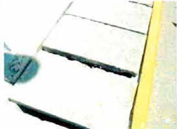
Estado de piezas de cobertura de galería de servicios
