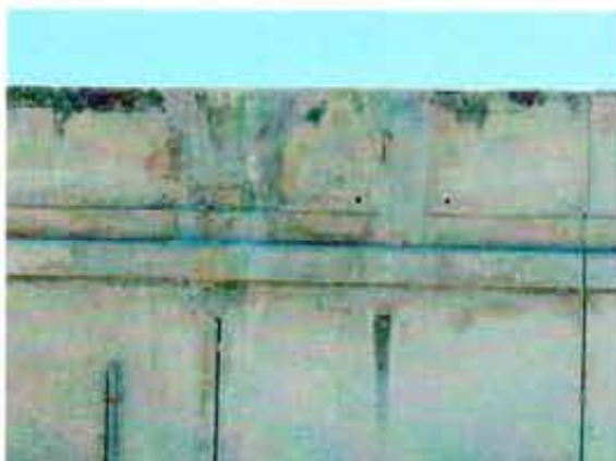
Reparaciones y grietas en paneles
