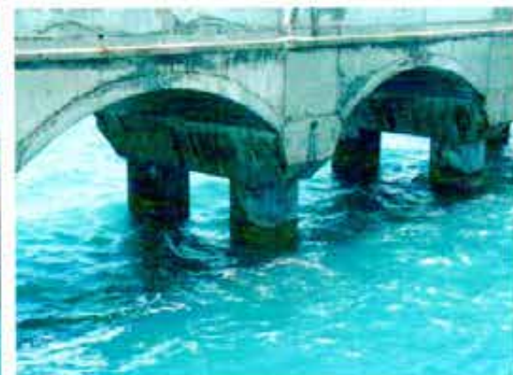
Juntas abiertas en arcos. Eflorescencias
