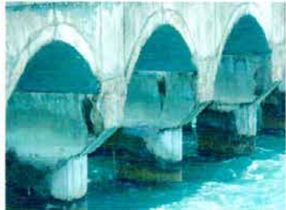
Juntas en arcos. Ligeras pérdidas de material
